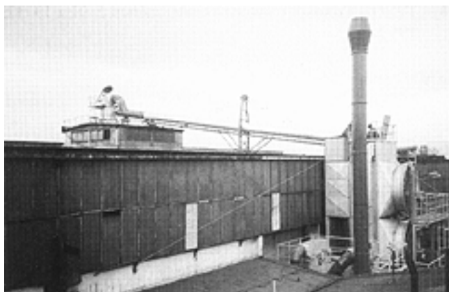
Obr. 1. Výstupní potrubí z kuplovny, chladič, komín z filtru FVU.
