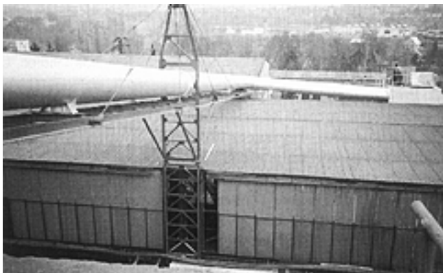
Obr. 1. Potrubí o průměru 900 mm z kuplovny do chladiče
