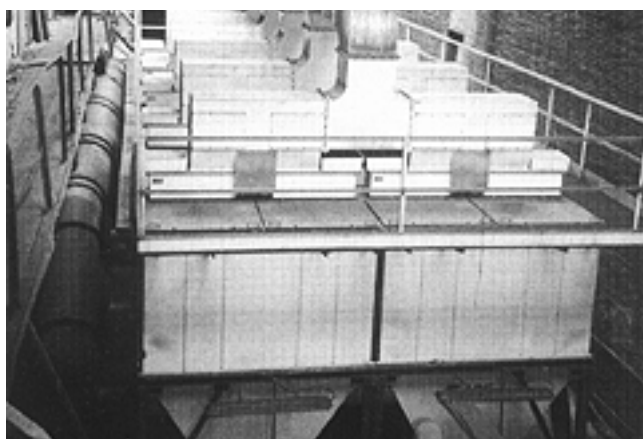
Obr. 5. Filtrační stanice 10 x FVU - 200.
