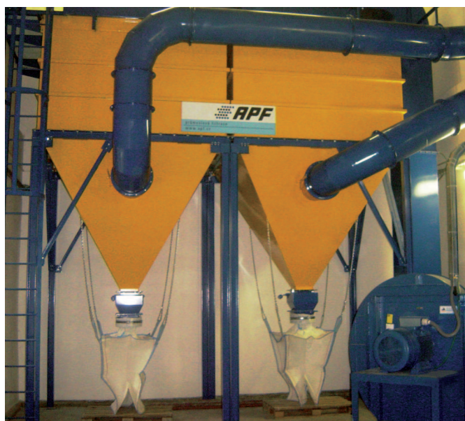
Obr. 1. Filtrační stanice FVU.I – SIGNUM-SK, Prievidza, SK
